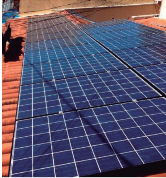
Figura 3 – Instalações Fotovoltaicas no Restaurante. Fonte: Elaboração Própria
