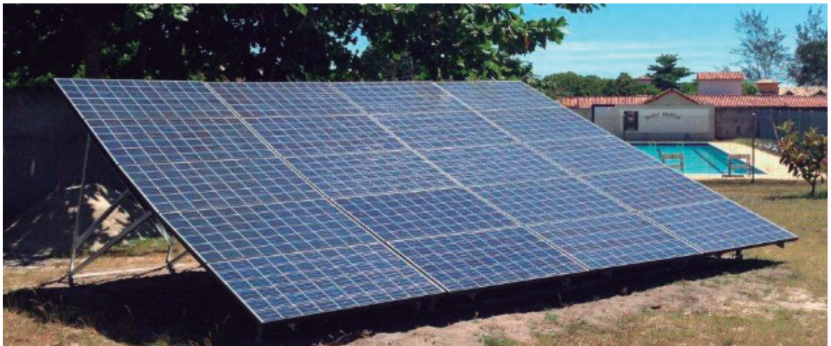
Figura 5– Instalações Fotovoltaicas na APAE Búzios. Fonte: (FORTES et al., 2014)
