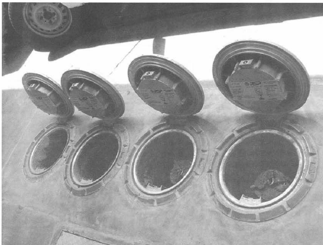
Figura 2 – Tampas de acesso inteligente
