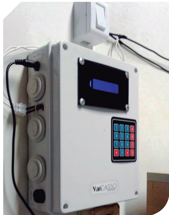
Figura 4 - Dispositivo instalado e em funcionamento (Fonte: autores)
