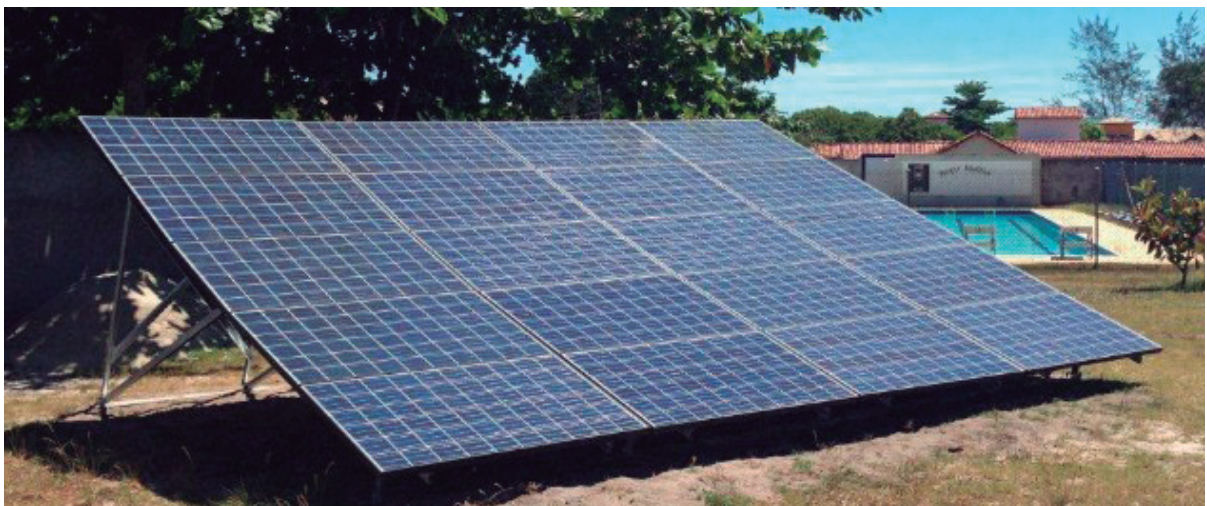
Figura 5– Instalações Fotovoltaicas na APAE Búzios. Fonte: (FORTES et al., 2014)
