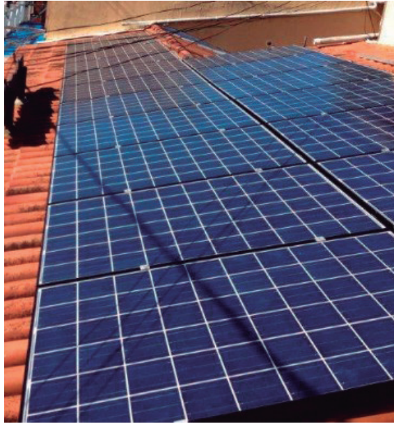
Figura 3 – Instalações Fotovoltaicas no Restaurante. Fonte: Elaboração Própria
