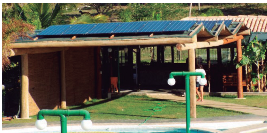
Figura 2 - Instalações Fotovoltaicas no Clube de Tênis. Fonte: (FORTES et al., 2014)
