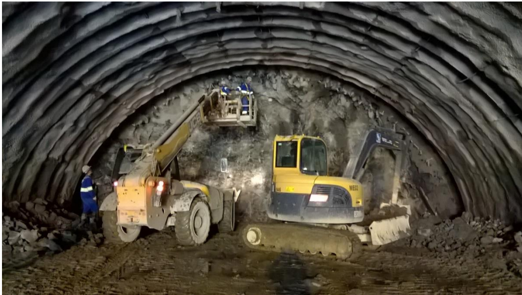
Figura 2: Inspeção de tirantes e retirada de entulho nas obras do túnel da BR-280 em 2016/2.
