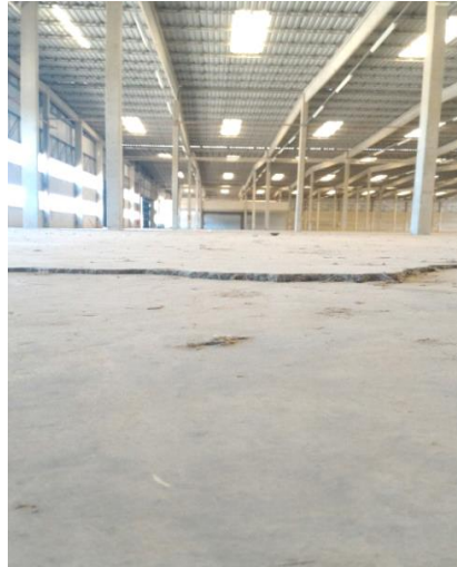
Figura 4. Recalque do aterro. Fonte: André Correa Macedo, 2010.
