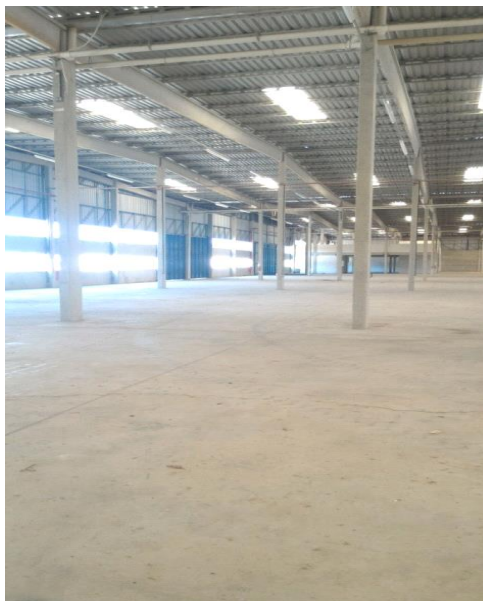
Figura 5. Perda de verticalidade dos pilares. Fonte: André Correa Macedo, 2010.
