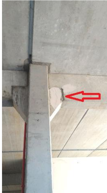
Figura 7. Fissura no console do pilar. Fonte: André Correa Macedo, 2010.
