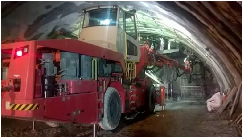
Figura 3: Perfuração da rocha com uso de perfuratriz pneumática nas obras do túnel da BR-280 em 2016/2.
