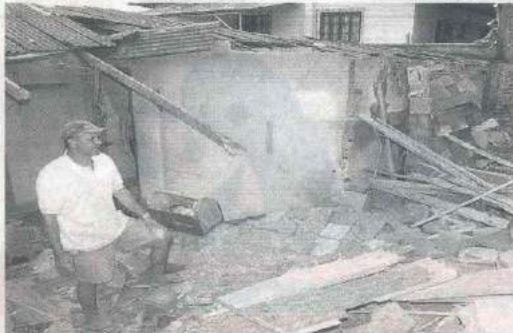
Alcides teve a casa destruída por um deslizamento de terra, em Camboriú
