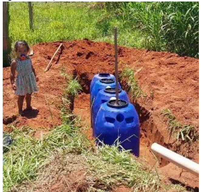
Figura 7: fossa séptica (Assentamento Zumbi dos Palmares).
