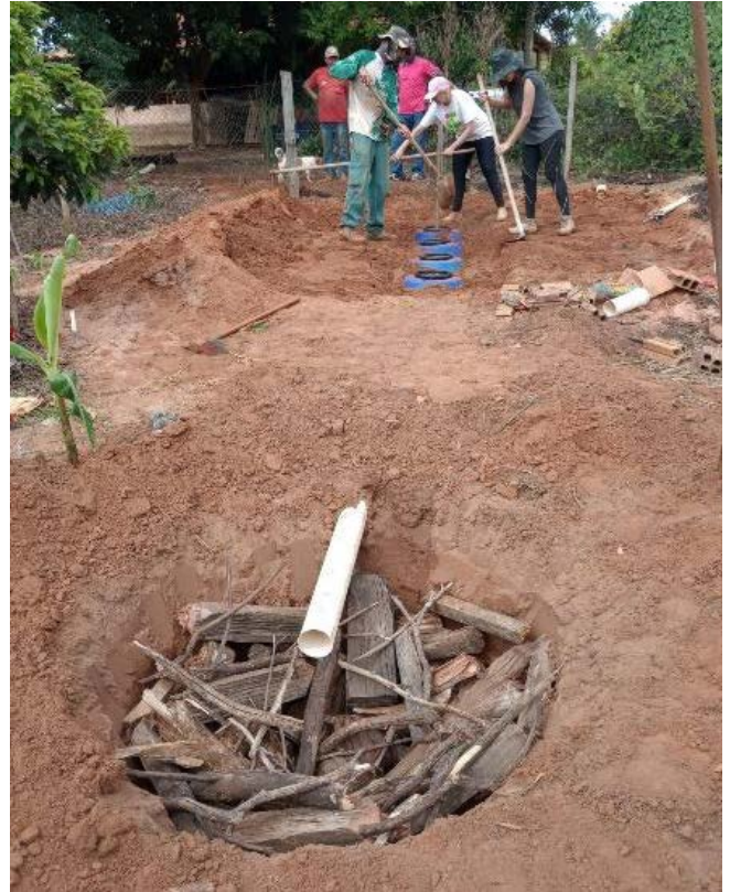
Figura 6: fossa séptica de baixo custo (Assentamento Zumbi dos Palmares).
