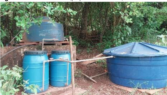
Figura 5: filtro lento de areia (propriedade em Avaré).
