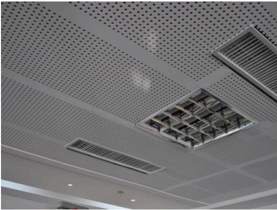
Figura 9 - Forro acústico perfurado
