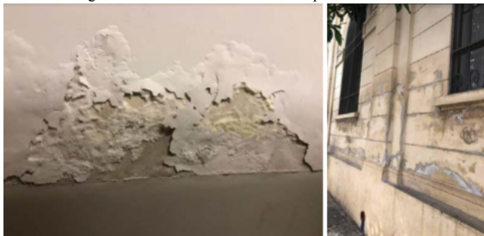
Figuras 7A e 7B - Eflorescências nas paredes do Anexo
